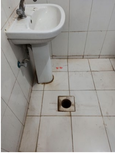
حوض تالف لغسل اليدين وفتحة تالفة لتصريف المياه الأرضية
